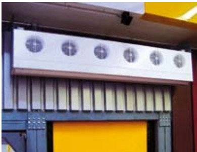
Установка INDUVENT, модель S. Смонтирована горизонтально над воротами. Воздухозабор впереди.
