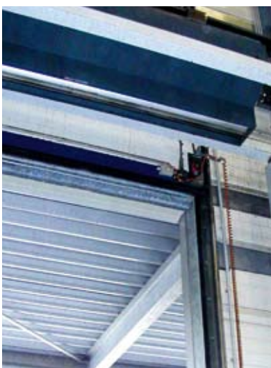
Установленная горизонтально над воротами сопловая система EVOLVENT® также обеспечивает оптимальную экранирующую мощность до самого пола.
